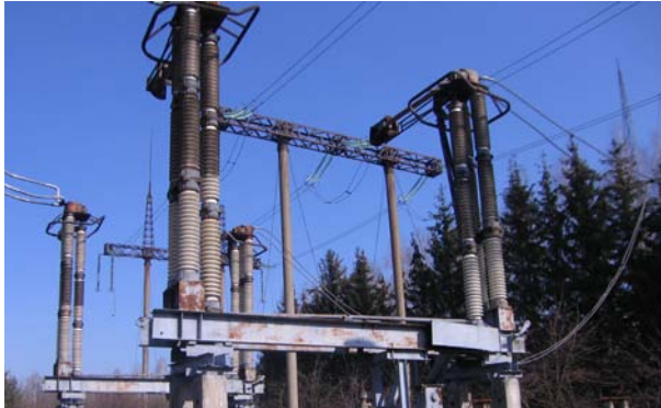
Рисунок 1.1 – Відремонтований роз'єднувач 330 кВ
