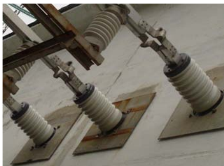
Рисунок 1.4 – Прокідні ізолятори ЗРУ 15 кВ
