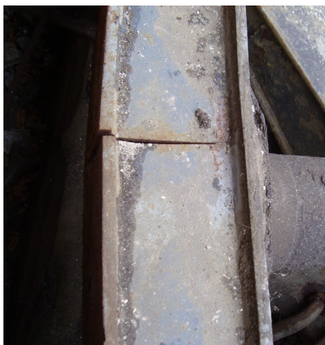
Рисунок 1.3 – Тріщина шкворневої балки трамвая
