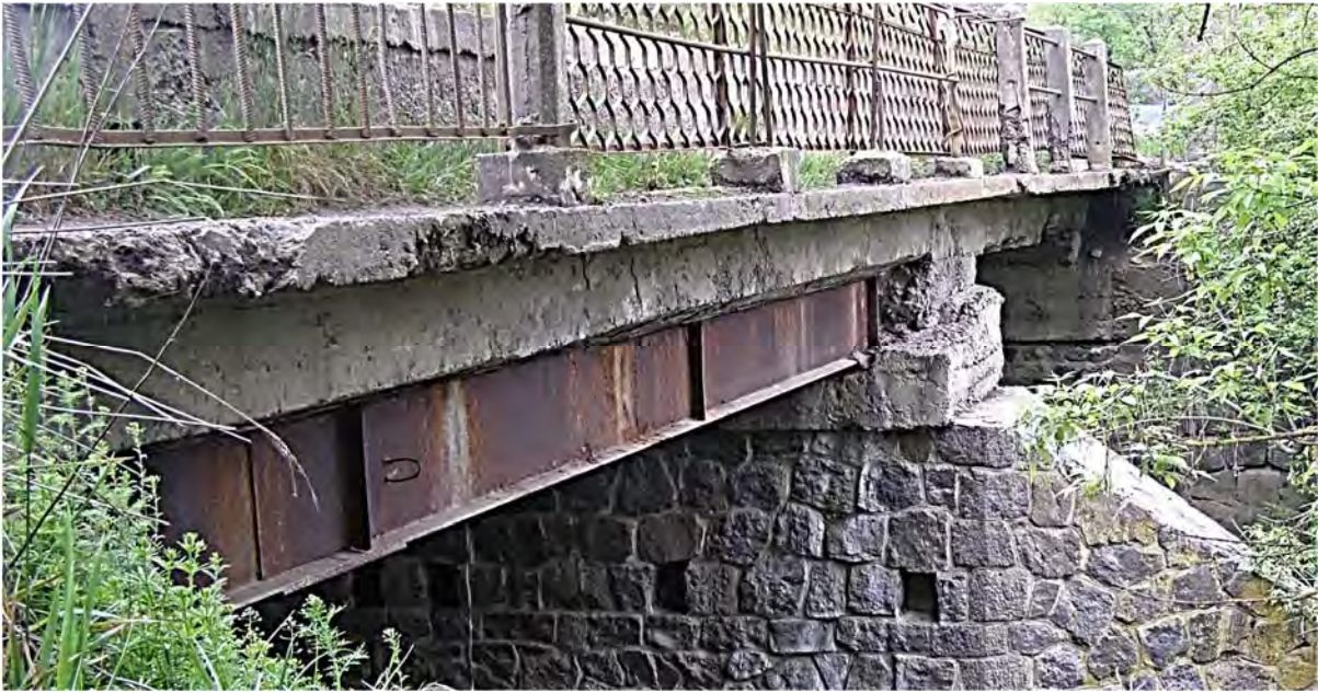
Рис. 2. Стан мостової споруди через р. Сіб на 2020 рік: корозія сталевих конструкцій, руйнування захисного шару бетону, перильне огородження не відповідає сучасним нормам, бар'єрне огородження відсутнє.
