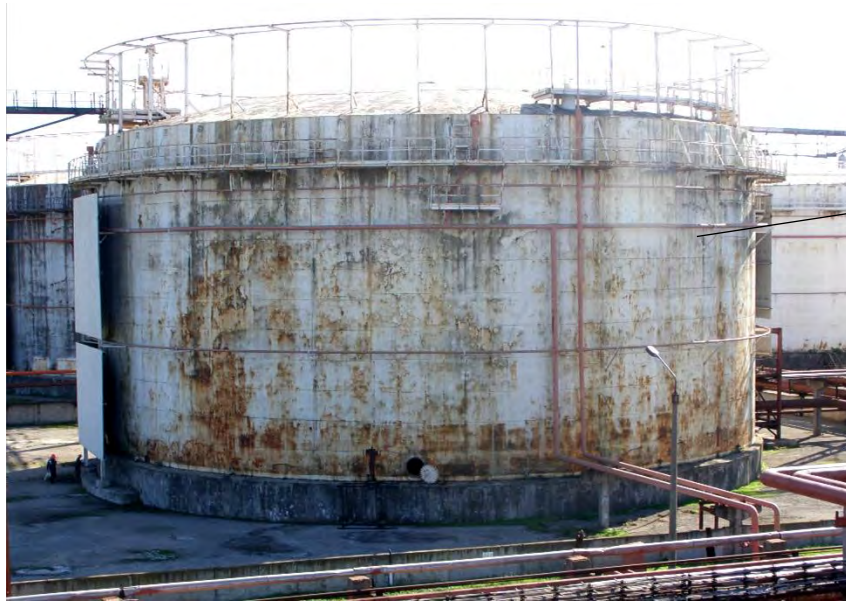
Рис. 1. Типовий великорозмірний резервуар для зберігання метанолу на одному з підприємств хімічної промисловості України. Зовнішній вигляд і стан
