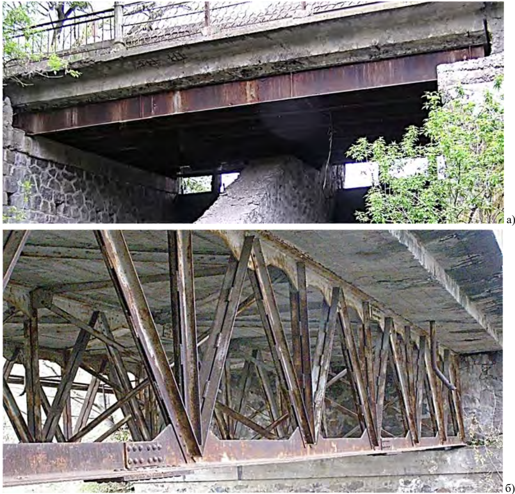
Рис. 1. Приклади існуючих автодорожніх сталобетонних мостів Вінницької області, їх загальний вигляд і типовий стан: а – мостова споруда у м. Липовець, б – міст у смт. Дашів.
