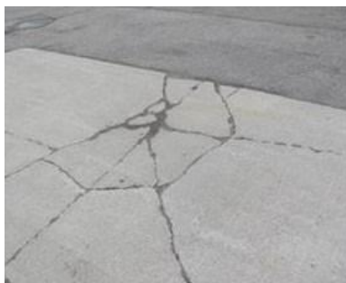
є – вибоїни у дорожньому покритті;
