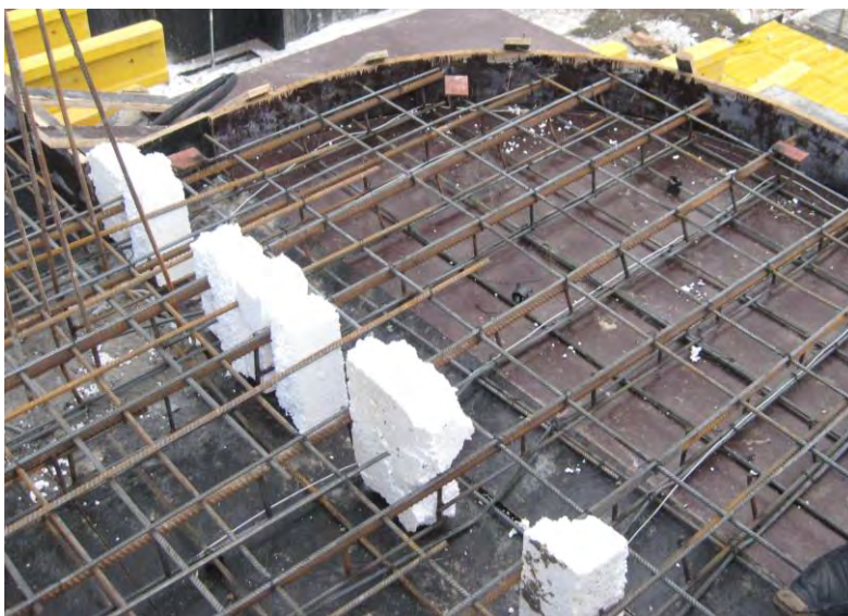
Рис. 6. Приклад встановлення теплоізоляційних вкладишів з порушенням вимог проекту
