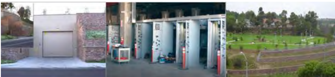
Рис.2 Підземна підстанція у місті Анахайм[1]
