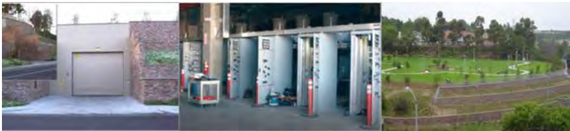
Рис.2 Підземна підстанція у місті Анахайм[1]
