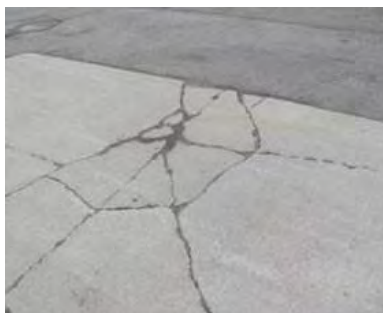
є – вибоїни у дорожньому покритті;
