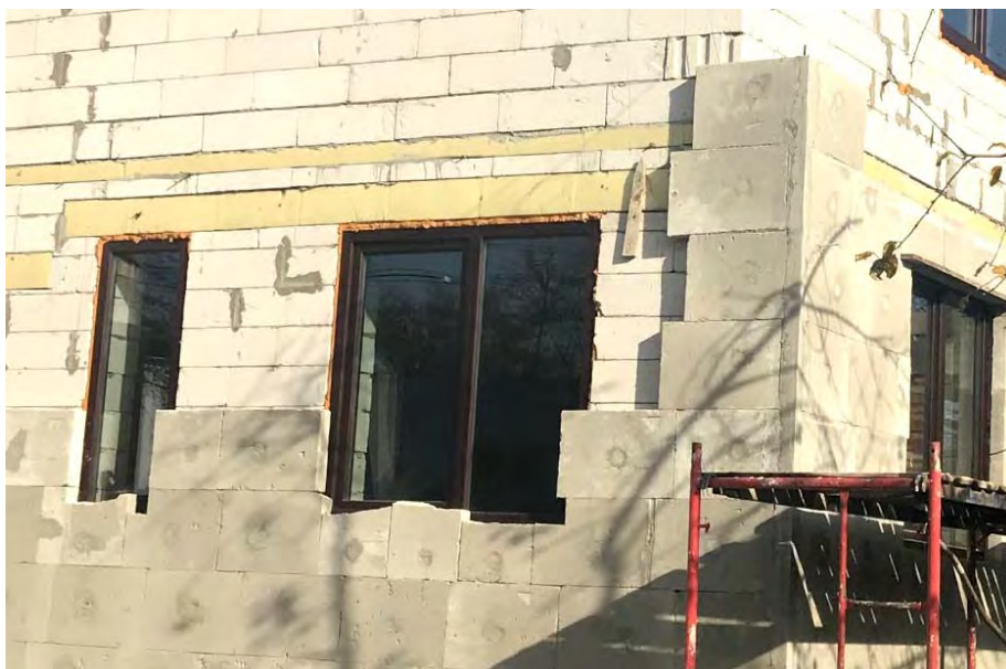
Рис. 1. Принципове рішення шаруватої конструкції зовнішньої стіни з конструкційного газоблоку, утепленої високопористими газоблочними панелями «Веліт» [7].
