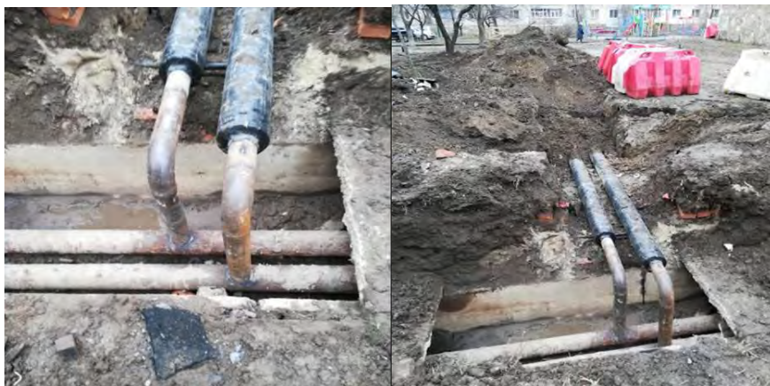
Рис. 1. Наглядний приклад неефективного використання попередньо ізольованих труб шляхом їх підключення до не утепленої теплової мережі, яка експлуатується з 1985 року.
