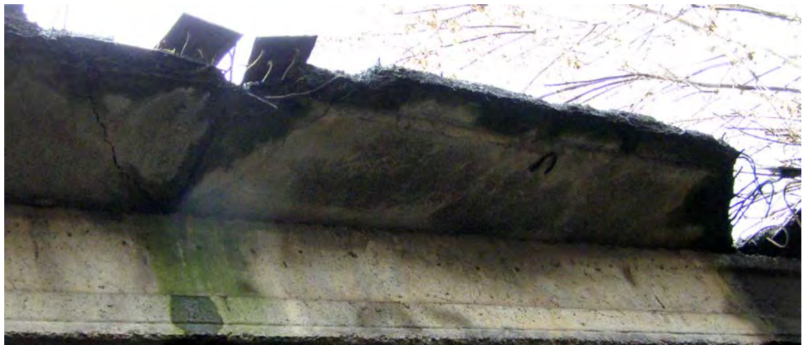
Рис. 2. Типові дефекти ребристих тротуарних плит на прикладі мостової споруди у с. Оляниця через р. Нетека у Вінницькій області. Сколювання бетону окрайків плит з оголенням та корозією робочої арматури, руйнування кріплення перильних закладних деталей, руйнування перильного огородження.
