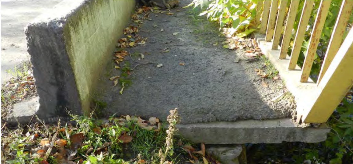
Рис. 1. Зовнішній вигляд та стан існуючих типових тротуарних конструкцій у вигляді збірної ребристої плити на прикладі мосту через р. Удич, с. М'якохід, Вінницька область. Ширина тротуару не відповідає вимогам чинних норм [5]. Конструкція бетонного бар'єрного огородження не відповідає вимогам норм [3].
